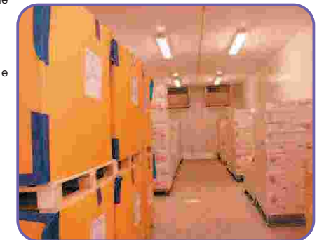
Cella SB44 con doppio impianto di refrigerazione
