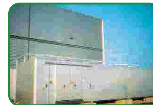
Due celle SB44 integrate in una struttura preesistente. Le celle sono dotate di porte laterali supplementari.
