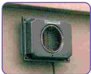
Valvola di decompressione all'interno della cella
