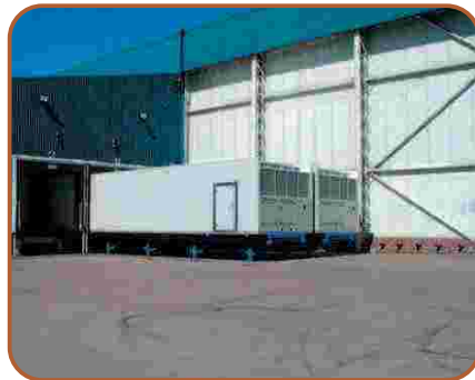
Due surgelatori modello MegaBlast collocati su una speciale piattaforma adattata all'altezza standard della rampa di carico
